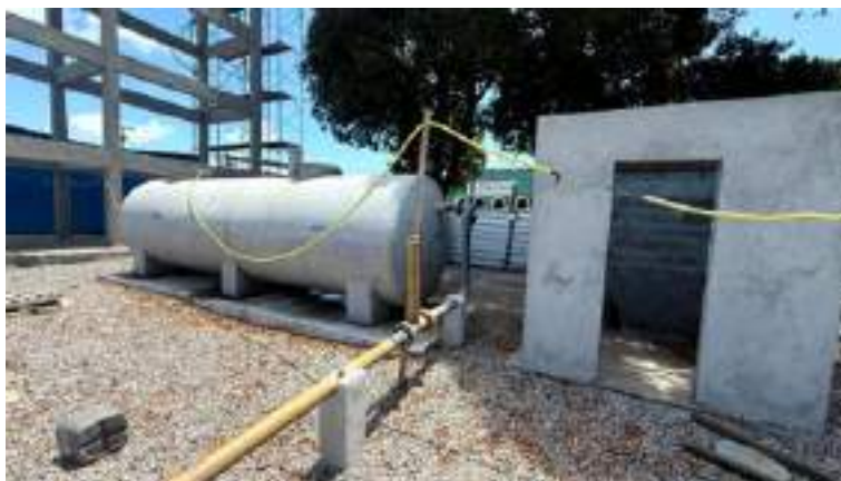
Figura 9 – ETE para tratamento do efluente sanitário.
